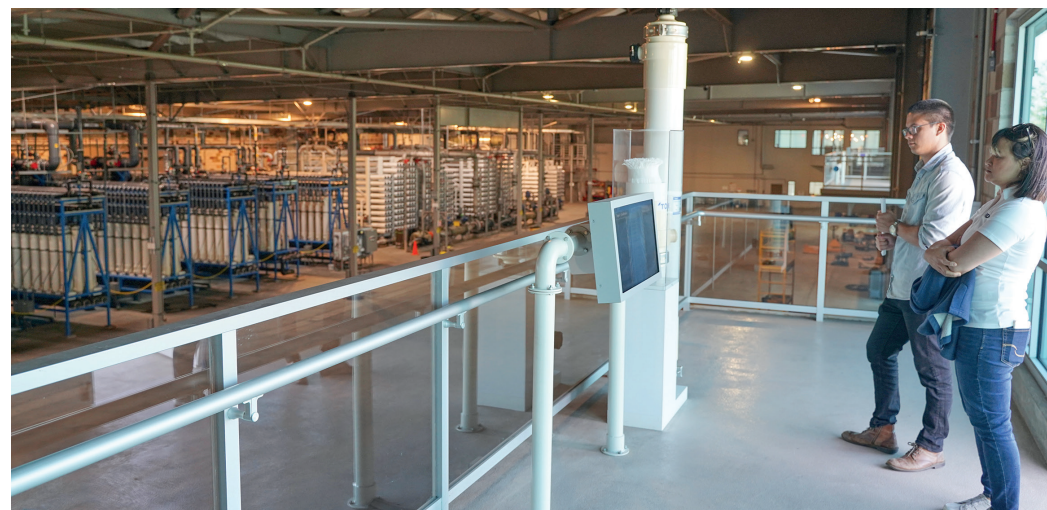
Figur 4: En av de tre utsiktsbalkongerna i Albert Robles Center. I bakgrunden syns ultrafilter (stående tuber) och omvänd osmosfilter.
